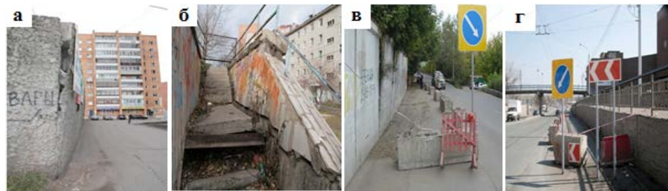
«Подпорные стены, находящиеся в аварийном состоянии» рисунок 3
